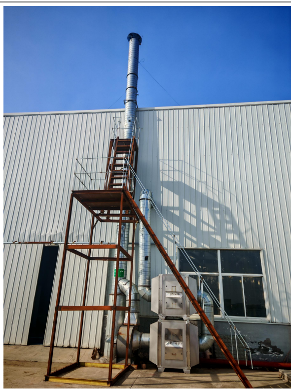
二级活性炭吸附+4#排气筒
