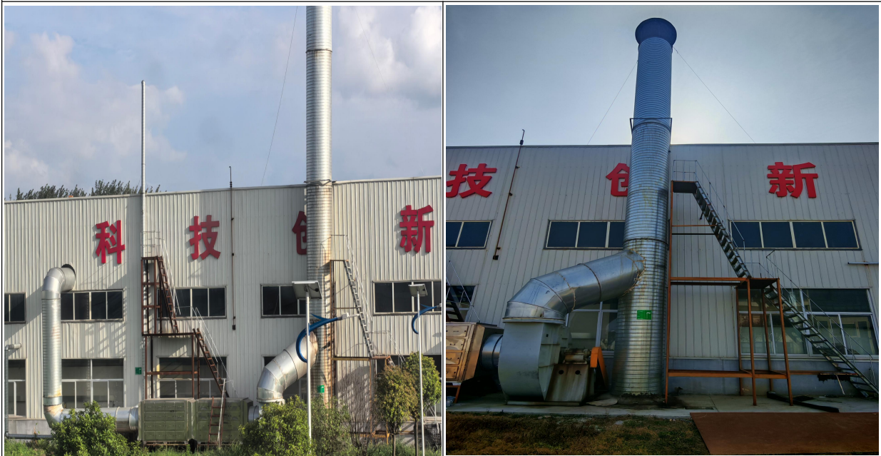
二级活性炭吸附+1#排气筒
