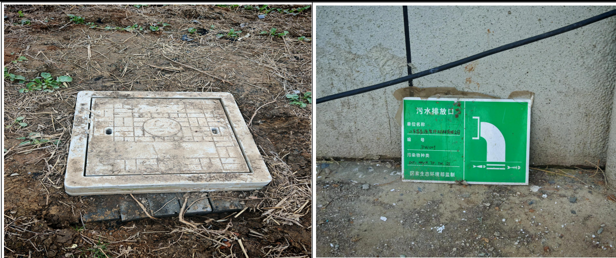
污水排放口及标志牌
