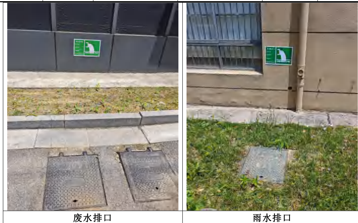
图 4.2 本次验收项目废水治理设施
