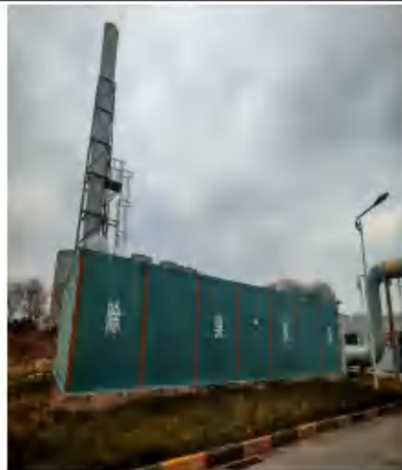
生物除臭设备系统
