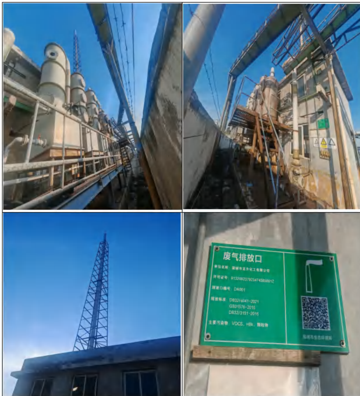
三级水喷淋+两级活性炭纤维吸附+1#排气筒
