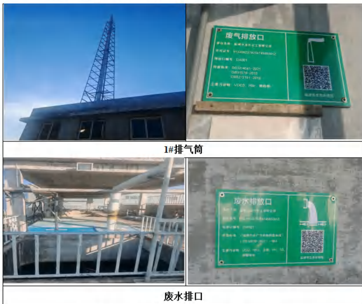
图 4.6 本次验收项目废水、废气排放口标志牌
